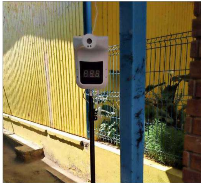
PIRQUE.— Los recintos ya tienen instalado el equipamiento necesario. En la foto, el termómetro en el ingreso del liceo municipal El Principal.
